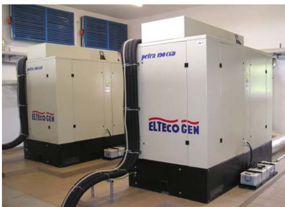
Čistička odpadových vôd Grudziadz, Poľsko (2002)
