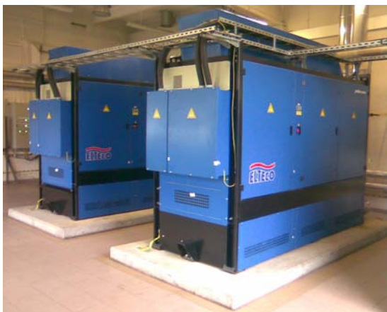
Čistička odpadových vôd, Zabrze Poľsko (2007)
